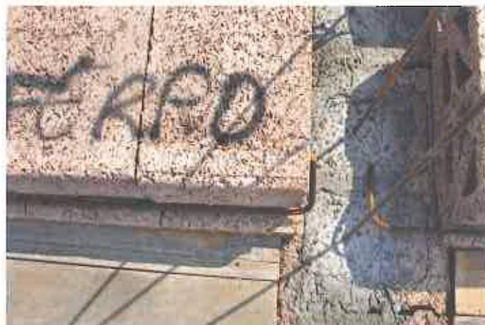
Sormonto dei solai sulle pareti
